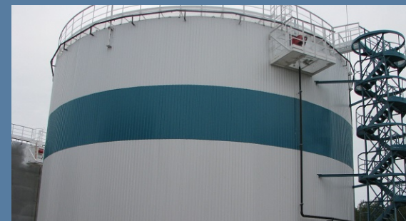
Баки-аккумуляторы горячей воды
