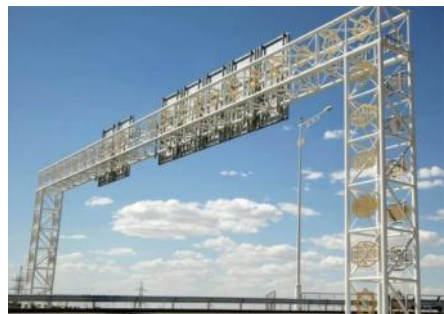
Рамные опоры дорожных знаков
