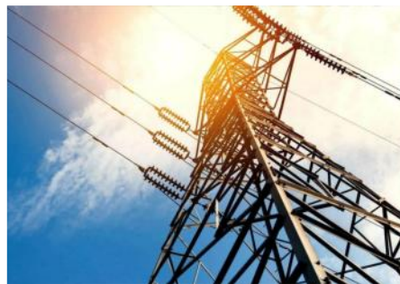
Опоры ЛЭП и ВЛ
